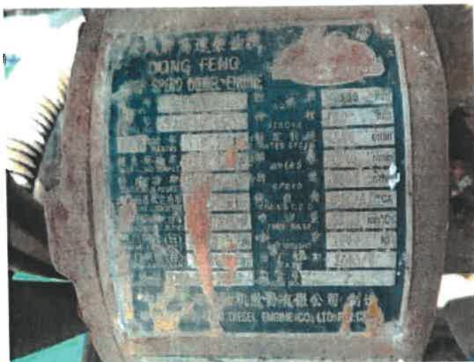
(14) 该船抽吸泵驱动柴油 油机设备铭牌
