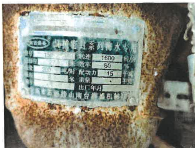
(17) 标题船冲水泵设备 铭牌
