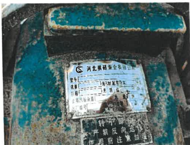
(15) 标题船抽吸泵设备 铭牌
